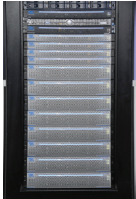
Стойка с серверным оборудованием Omneon
